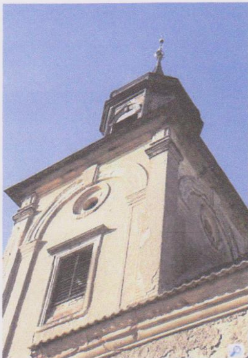
Die Kirche in Ahlsdorf muss dringend saniert werden. Im Inneren fällt der Putz von der Decke. sk
